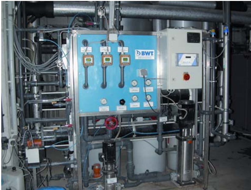
Schaltschrank Abwasseraufbereitung und UV-Bestrahlung
